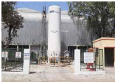
20 किलो लीटर नाइट्रोजन गैस प्लांट, रेडिका, कपूरथला
