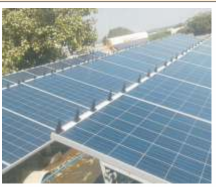
राजकोट स्टेशन पर सोलर प्लांट
